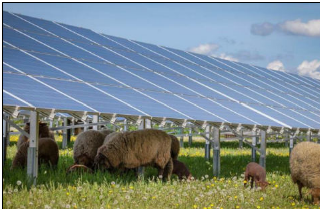
Abbildung 100: Beispiel Freiflächen-Photovoltaikanlagen; Quelle: https://outarky.de/loesungen/photovoltaik/freiflaechen-photovoltaik/
